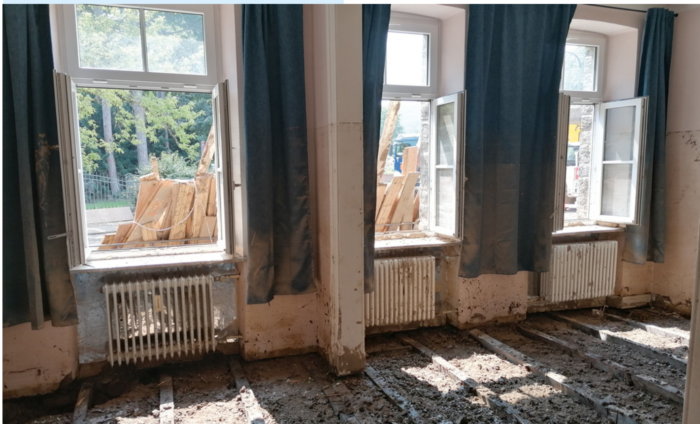
Die Wasserfolgeschäden sind derzeit noch nicht vollständig überschaubar. Das Haus hat mit seiner soliden Substanz aber einiges „besser verkräftet“ als moderne Bauten. Es verfügt über keinen Estrich, wie ansonsten üblich, der nun mühsam herausgeschlagen werden müsse.
